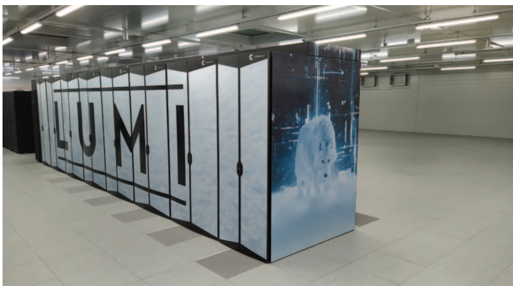
Zdjęcie pierwszej fazy instalacji LUMI. Fot. Juha Torvinen, CSC
