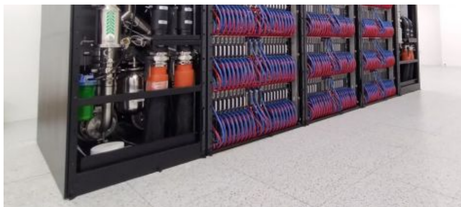
Wnętrze superkomputera Helios - szafy obliczeniowe (w środku) oraz szafy chłodzące (po bokach)
